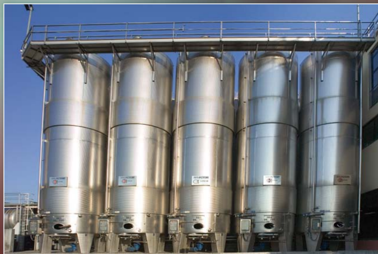
CANTINA VALPOLICELLA_NEGRAR (VR) n.5 Selector hl 800
