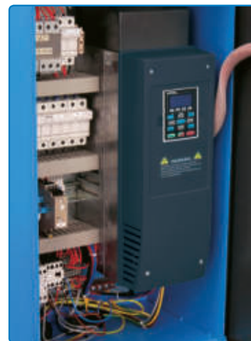
Quadro elettrico e inverter.
