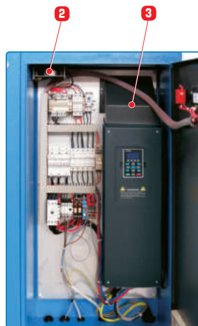
Quadro elettrico e inverter.
