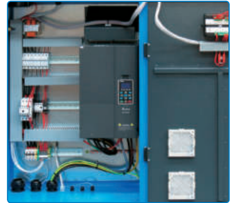
Quadro elettrico e inverter.
