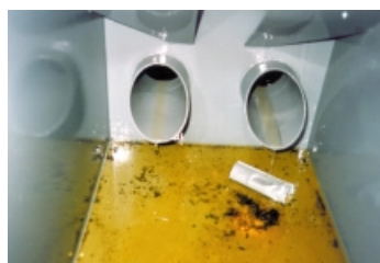
Korrosion Tankboden Corrosion on floor of reservoir Corrosion au fond du réservoir
