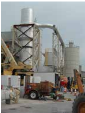
Beispiel einer Anlage in Nord Amerika Example of an installation in North America
