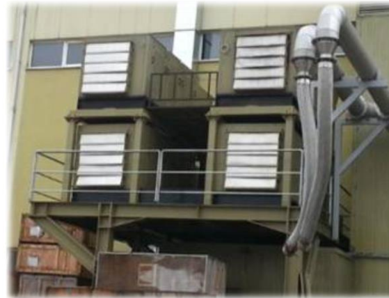
3,2 MW Yük Bankası
