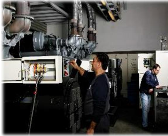
MV test yetkinliği (2,5MVA – 3,3/6,3/11kV)
