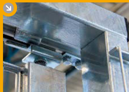
STABILE TÜRTRVERSE auch zur Kabelführung geeignet
